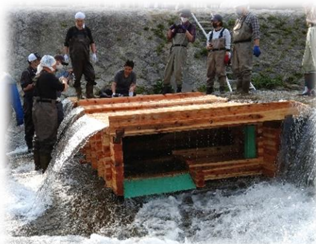
▲簡易魚道の設置（鴨川）
