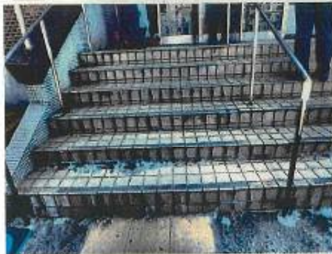
本館玄関前の老朽した階段
