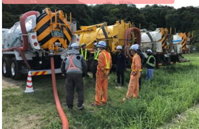
塩素混和池からのホースを給水車に接続
