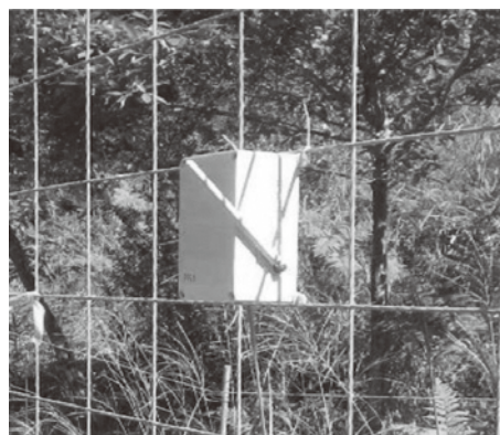
防護柵に取り付けた 無線振動センサー
