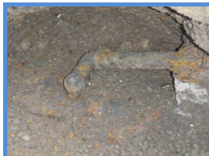
○埋設年数 : 50年 ○建物 : 雑居ビル ○所在地 : 北海道札幌市
