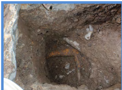
○埋設年数 : 50年 ○建物 : 雑居ビル ○所在地 : 北海道
