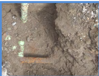
○埋設年数 : 45年 ○建物 : 雑居ビル ○所在地 : 北海道札幌市
