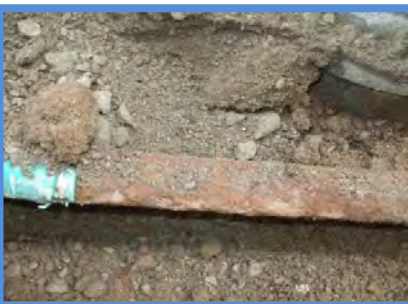
○埋設年数 : 45年 ○建物 : 雑居ビル ○所在地 : 新潟県長岡市
