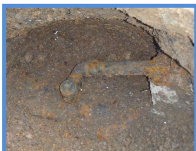
○埋設年数 : 49年 ○建物 : 雑居ビル ○所在地 : 北海道
