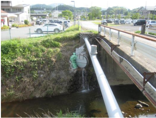
背水影響対策(フラップゲートの設置 令和6年度実施)
