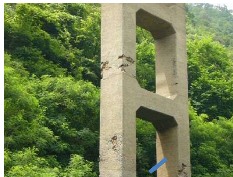
写真-K 橋脚の損傷状況(肱谷橋)
