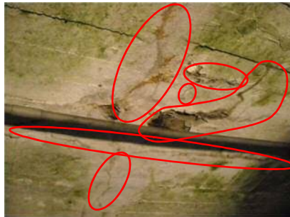
写真-B トンネル側面のクラック
