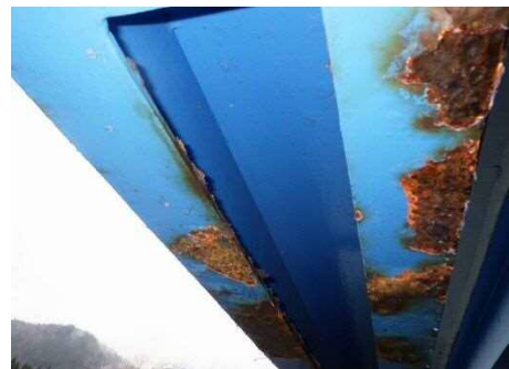
写真-I 部材の損傷状況(音海橋)
