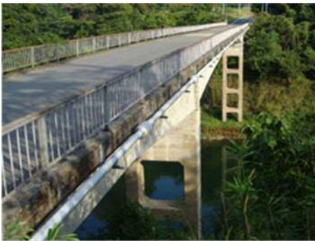
写真-J 肱谷橋の状況
