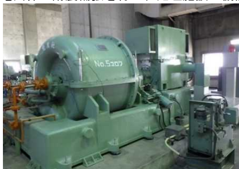
送風機設備（更新）
