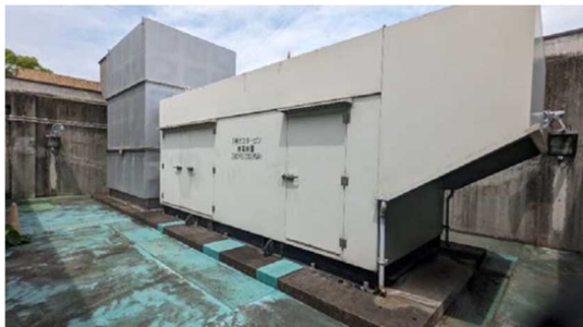
非常用発電設備（増設）
