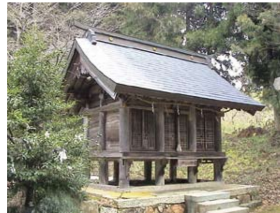
石田神社(綾部市) 重要文化財・境内社恵比須神社本殿 アライグマによる壁板破損の修理
