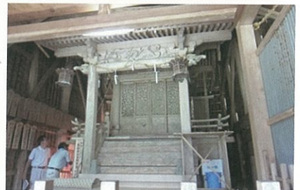
写真⑥ 熊野神社・本殿(舞鶴市) (未指定文化財・保存修理)
