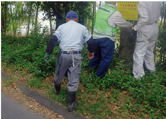
不法投棄防止のための警告看板の設置
